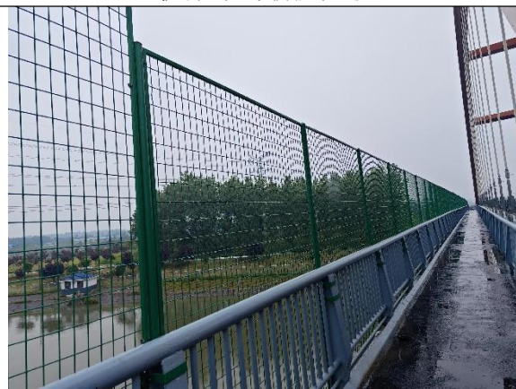
淠河总干渠大桥防落物网
