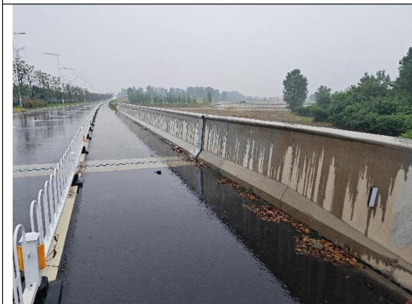
桃源河1号桥防撞墩
