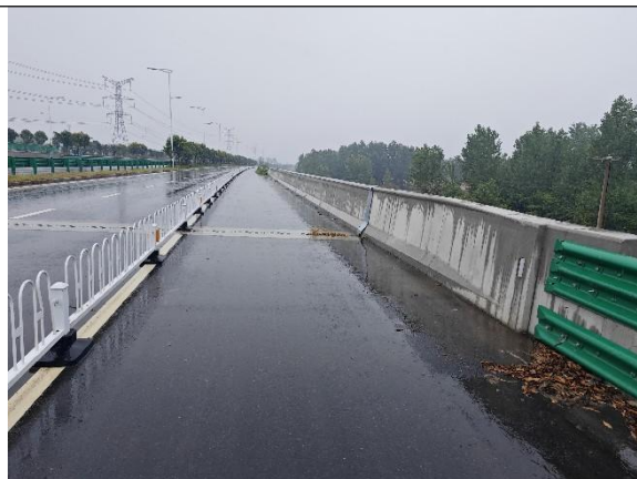
桃源河2号桥防撞墩
