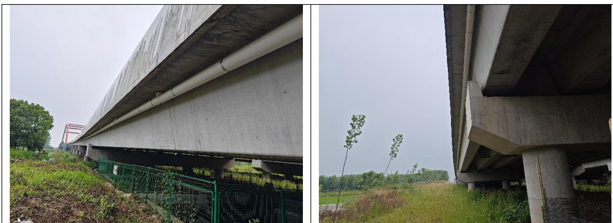
淠河总干渠大桥径流收集系统
