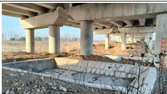
K14+945 汲东干渠大桥桥下事故应急池
