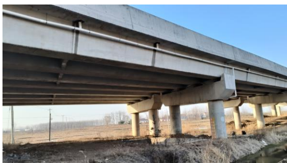
K14+945 汲东干渠大桥桥面径流水收集管网
